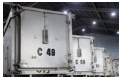
实施退火的热电炉
