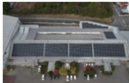
2024年3月、OPC山梨工場に設置した太陽光パネル 提供：関西電力株式会社
