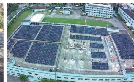
小原光学(中山)有限公司工厂屋顶上的太阳能板
